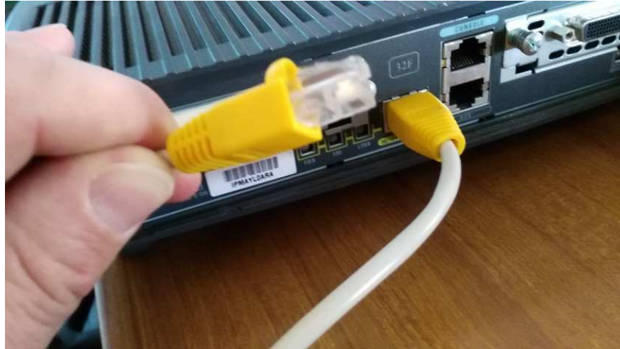
Router con cavo Ethernet
